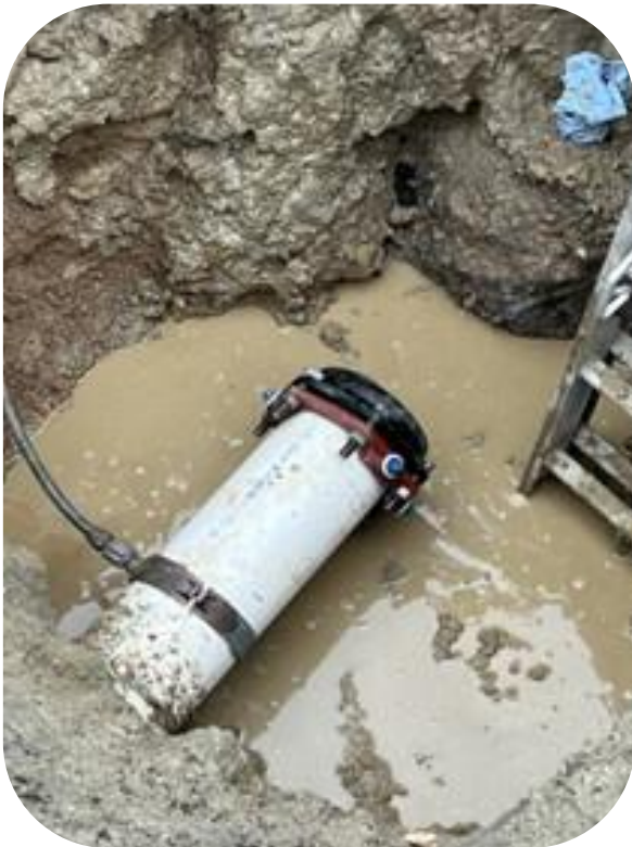
Watermain Break on Podtburg Circle
